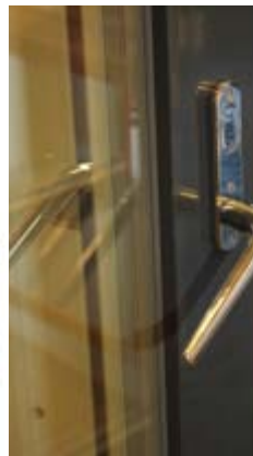
Aukipitolaitte lukittu puutteellisesti. Älä yritä liikuttaa ovea väkisin!
