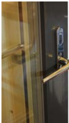
Ovilehti liikkuu vapaasti. Aukipitolaitte ei lukossa.
